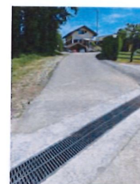
Barrière pont de la Gerbaz 5'000€ + nettoyage et pose caniveaux par le ST
